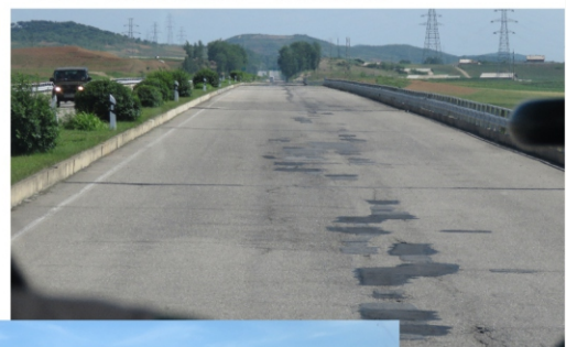
〈圖5〉路面破損嚴重，修補再修補
